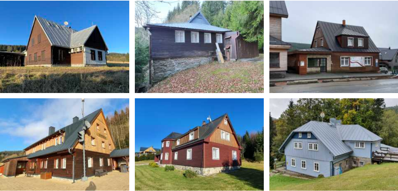
Horizontální deštění je třeba vnímat v naprosté většině případů jako problematické a nevhodné napodobování vodorovného deštění roubení. Vodorovné deštění nemá adekvátní detail a je nevhodné z hlediska stavebně technického. Za negativní příklady např. čp. 52, 73 a 123 HMÚ a 104 a 125 DMÚ. Výjimečné pozitivní příklady jsou zejména historické objekty, u nichž deštění vychází z variace na deštění roubení, např. čp. 112 DMÚ.
